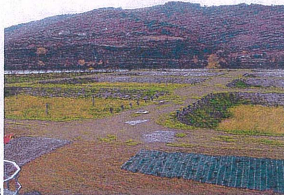
Derrière la station classique, huit bassins sont plantés de phragmites pour une surface de traitement de 3 200 m 2 .
