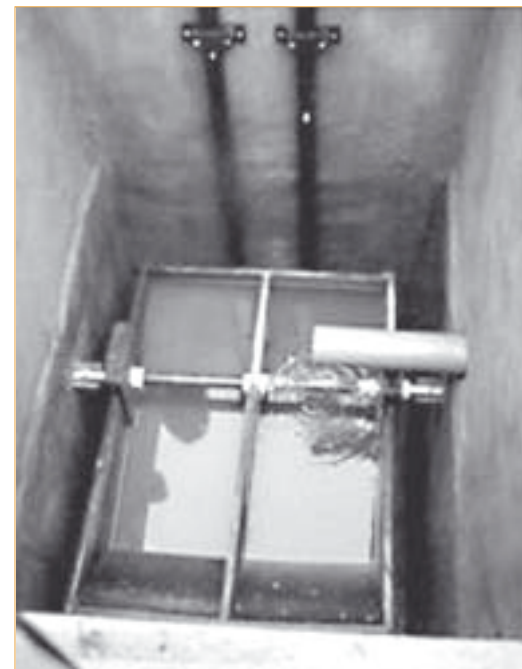
▼ Photo 2 – Auget basculeur installé après la sortie de la FTE dans une ferme de la Loire.
