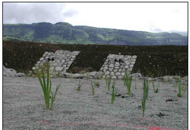
Neydens (74) - Rétention et filtration d'eaux pluviales conçue par SINT
