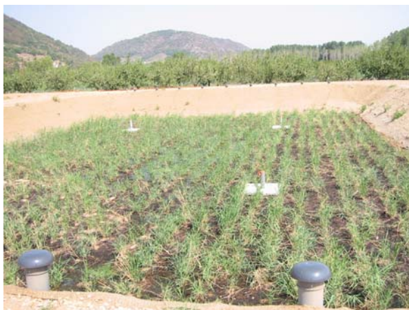
Lit de traitement des boues
