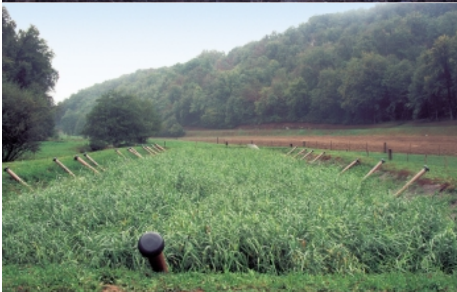
En haut: le 1 er niveau de filtres alors que les eaux usées se déversent par les tuyaux verticaux. Au centre: le 2 e niveau de filtres en travaux avec les tubes longitudinaux et les tubes d'oxygénation, débordant de la surface sur les quatre côtés. Enfin, en bas, le même filtre planté de jeunes roseaux, montrant l'allure quasiment définitive et «intégrée» du site.
